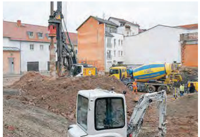
Auch in der Georgenstraße sind die Bauarbeiten für neue barriere-reduzierte Wohnungen in vollem Gange.
